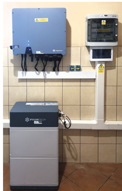
▲ Magazyny energii mają najczęściej tzw. budowę modułową, co oznacza, że ich pojemność można bez trudu powiększyć. SOLPLANET/GROSUN
