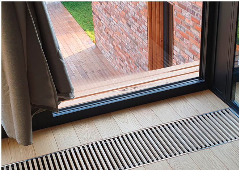
▲ Grzejniki kanałowe najczęściej umieszcza się w pobliżu dużych przeszkleń, takich jak drzwi tarasowe. Tam na zwykły grzejnik po prostu nie ma miejsca. VERANO
