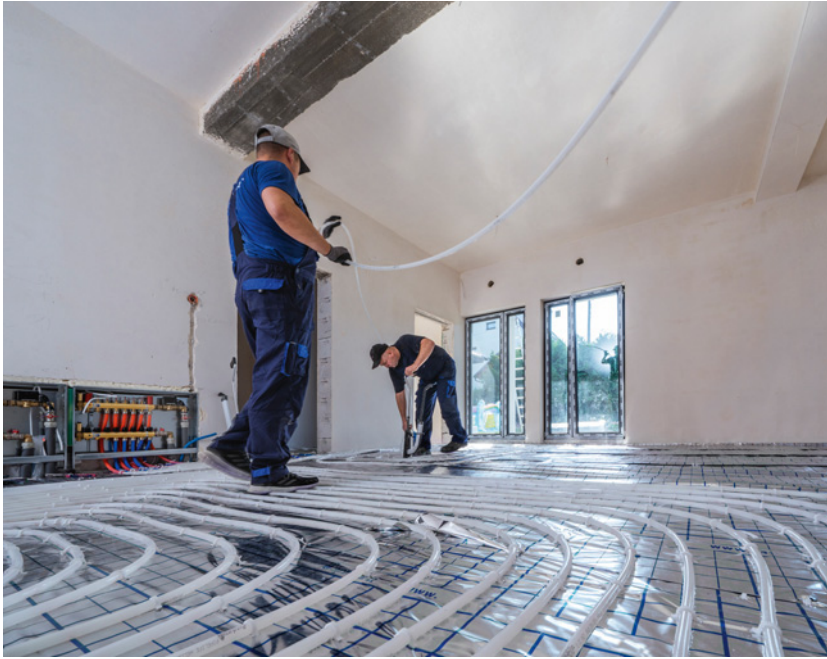
▲ W nowych domach z pompą najczęściej projektuje się podłogówkę. To z założenia ogrzewanie niskotemperaturowe. PIPELIFE
