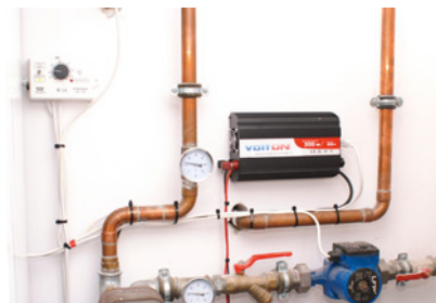
▲ W domu jednorodzinnym warto pomyśleć o możliwości awaryjnego zasilania przynajmniej takich urządzeń jak pompa obiegowa c.o., kocioł, pompa w studni. VOLTON
