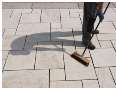
▲ Kostkę brukową układa się ciasno, a następnie fugi wypełnia się drobnym piaskiem. BRUK-BET
