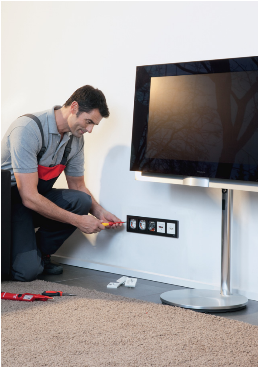
▲ Zdecydowanie lepiej zaplanować za dużo, niż za mało gniazd. Standardem powinno być co najmniej kilka takich typów osprzętu w każdym pomieszczeniu. SCHNEIDER ELECTRIC
