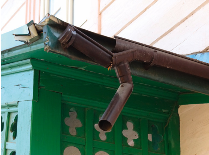
▲ Źródłem wilgoci w domu może być np. przeciekający dach, uszkodzone orynnowanie albo niepoprawnie zaizolowane fundamenty. GALECO
