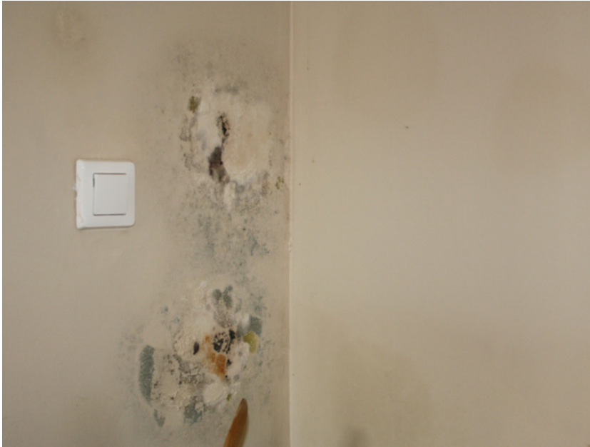
▲ Gdy wilgotność w domu jest za wysoka i brakuje wentylacji, na ścianach pojawiają się charakterystyczne wykwity pleśni. ARCHIWUM BD
