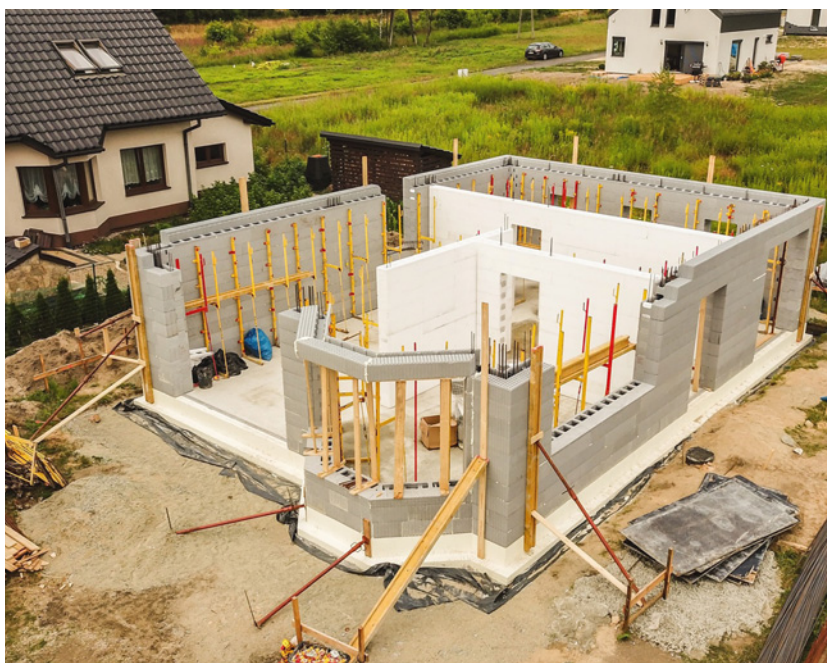
▲ Ściany z kształtek wznosi się ze styropianowych elementów, które następnie zalewane są betonem. IZODOM 2000 POLSKA
