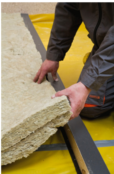
▲ Wełna mineralna stanowi skuteczną barierę akustyczną. Na zdjęciu układanie tego materiału pomiędzy legarami. PFLEIDERER
