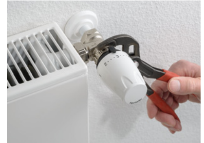
▲ Regulacja temperatury grzejników odbywa się za pomocą głowic termostatycznych. COMAP, IMI HYDRONIC ENGINEERING
