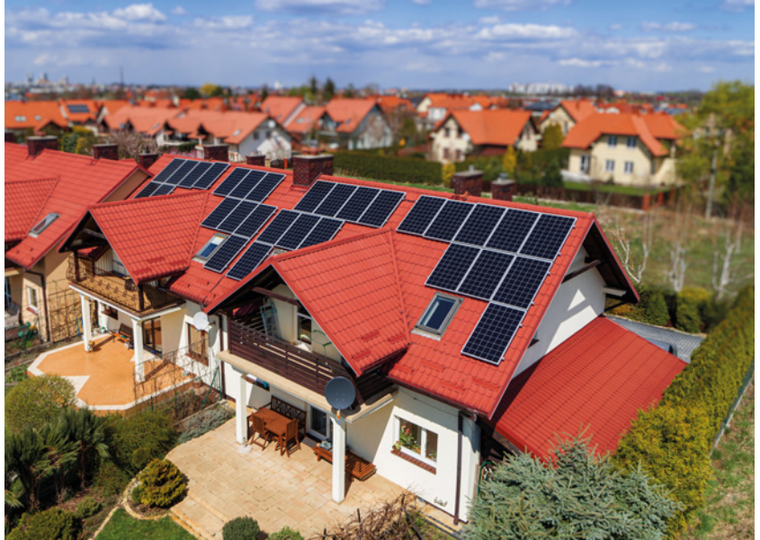
▲ Instalacja PV to dla większości inwestorów przede wszystkim panele. Jednak funkcjonalność systemu zależy głównie od wybranego rodzaju falownika. BRUK-BET FOTOWOLTAIKA
