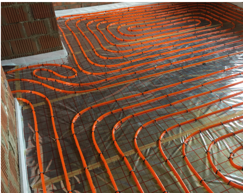
▲ Akumulatorem ciepła nie są same rurki z wodą, lecz wylewka podłogowa o dużej masie. RWC
