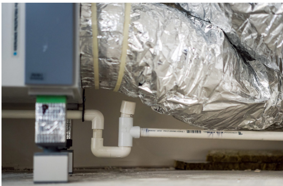
🔗 Odpływ skroplin z centrali. PRO-VENT
