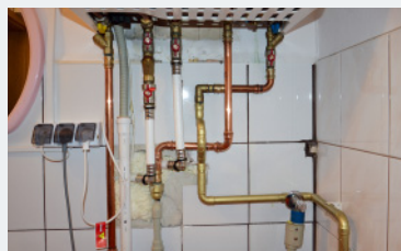
❷ Orurowanie kotła i rura PVC, odprowadzająca kondensat do kanalizacji.
